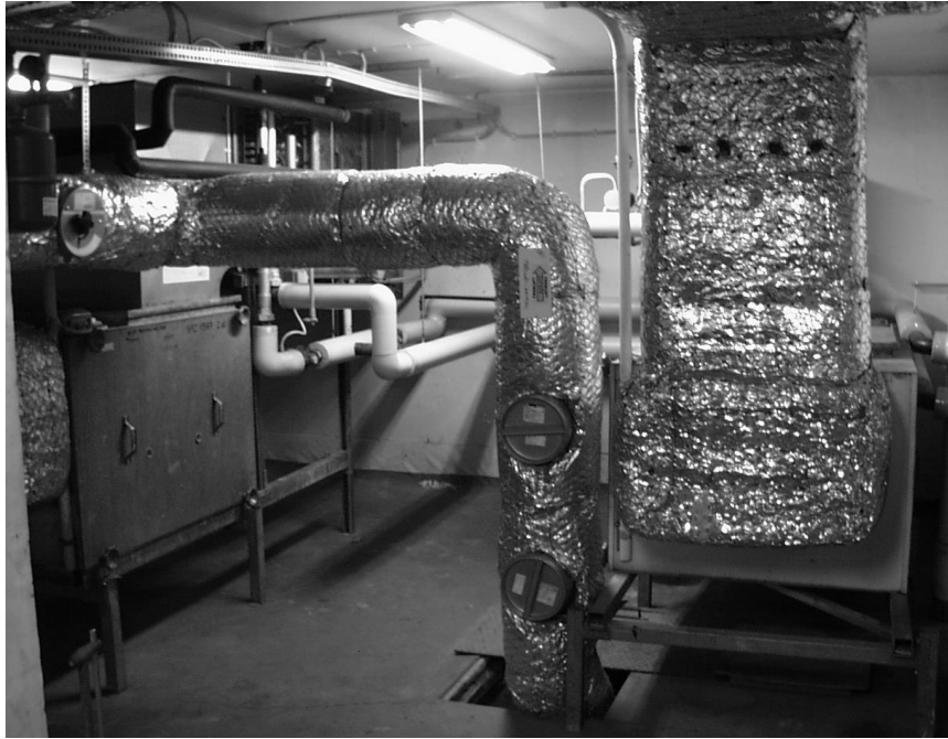
Figur 16. Del av ventilationsanläggning i Nordan 18. Foto: Stig-Inge Gustafsson.
