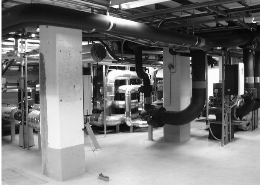
Figur 23. Fjärrvärmecentral i Solna Centrum. Foto: Stig-Inge Gustafsson.
