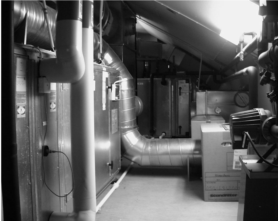
Figur 27. FTX ventilationssystem på vinden å daghem. Foto: Stig-Inge Gustafsson.
