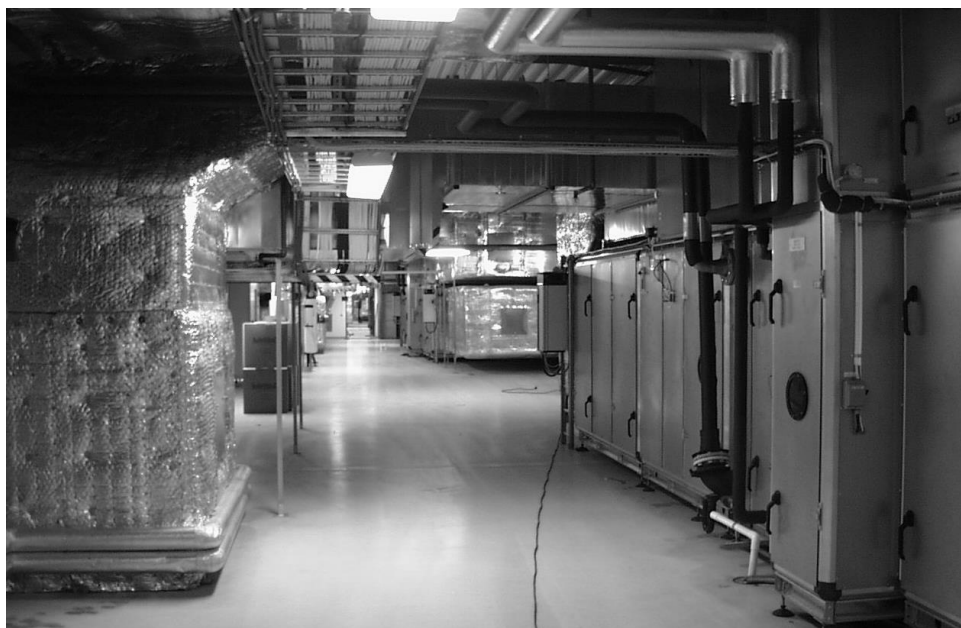
Figur 30. Ventilationsanläggning i byggnad å Fräsaren 11, Solna Business Park. Foto: Stig-Inge Gustafsson.
